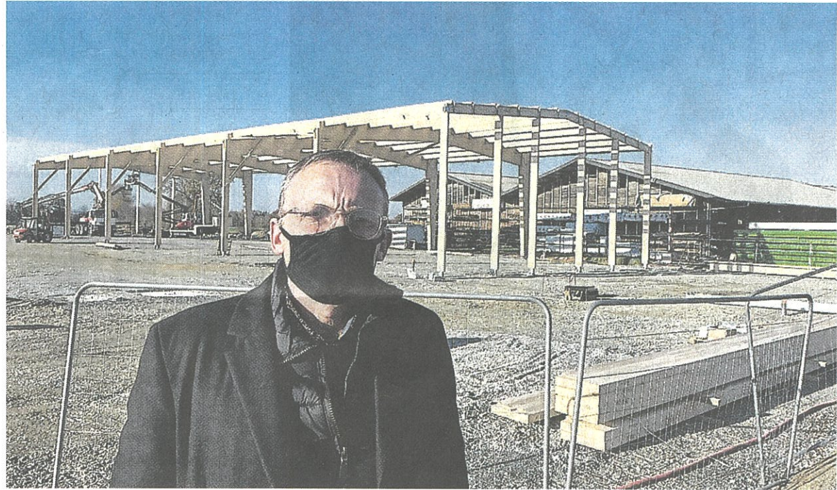
Pascal Dion, directeur général d'ARB, devant les travaux d'agrandissement en cours à Martigné-sur-Mayenne.
